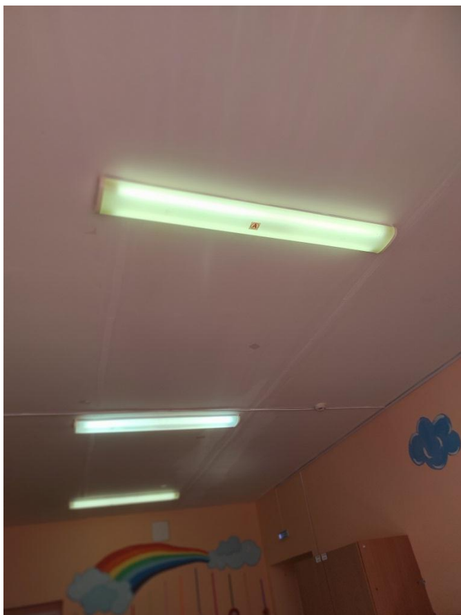
Освещение раздевальной комнаты подготовительной группы «Бережок»
